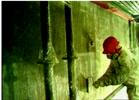
Figure 8 - Dépose d'une peau en matériau composite sur la paroi d'un bâtiment réacteur
